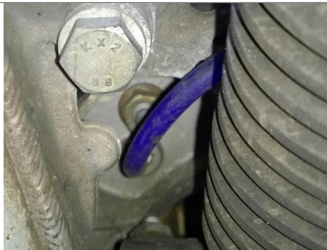
Abbildung 29: neuer Schlauch Motorlager Fahrerseite
