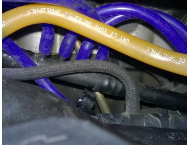
Abbildung 37: Fertig bestückter Verteiler Unterdrucksystem
